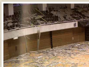
◀中越大震災で大きな 被害を受けた長岡市 市民体育館(平成16年)
